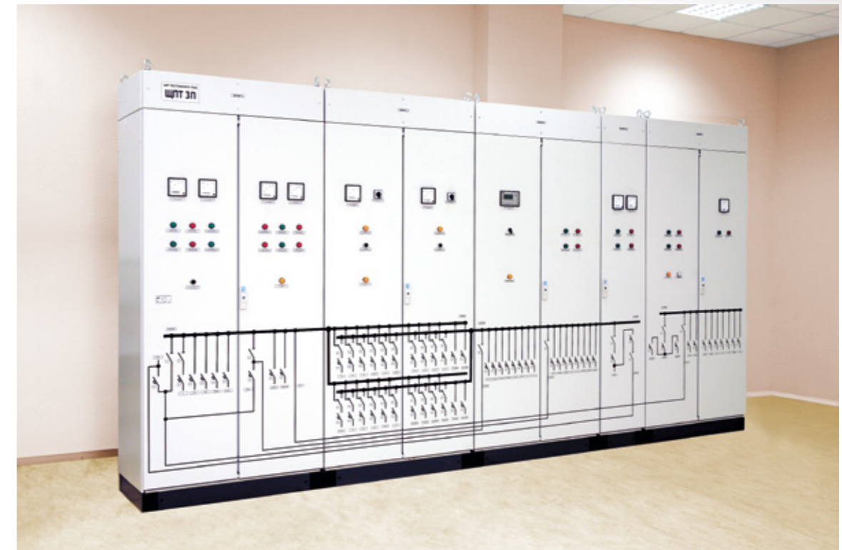
Щит постоянного тока одностороннего обслуживания
