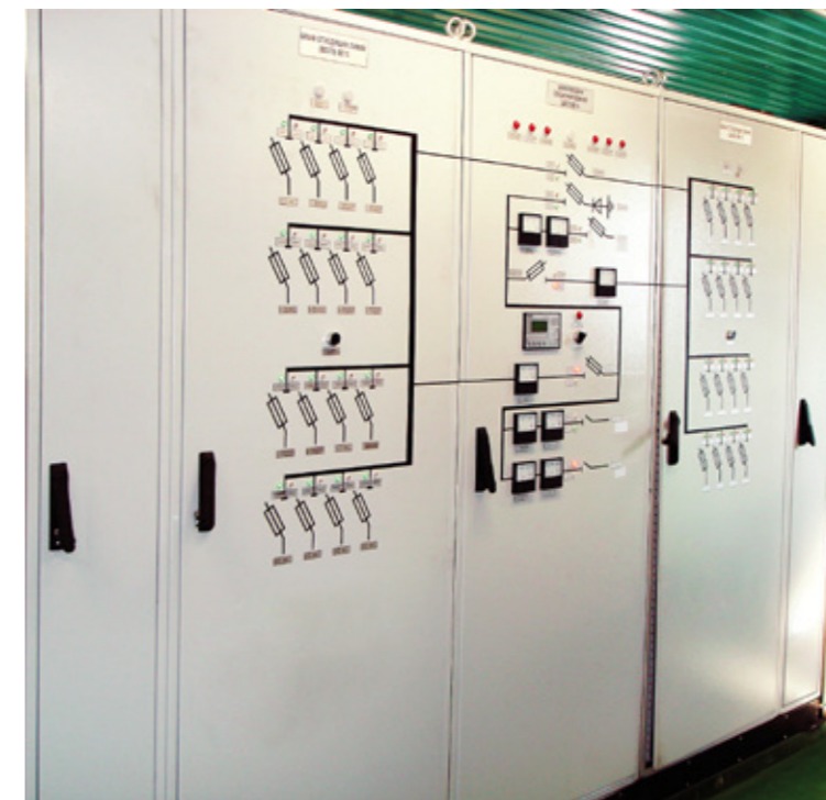
Щит постоянного тока двухстороннего обслуживания
