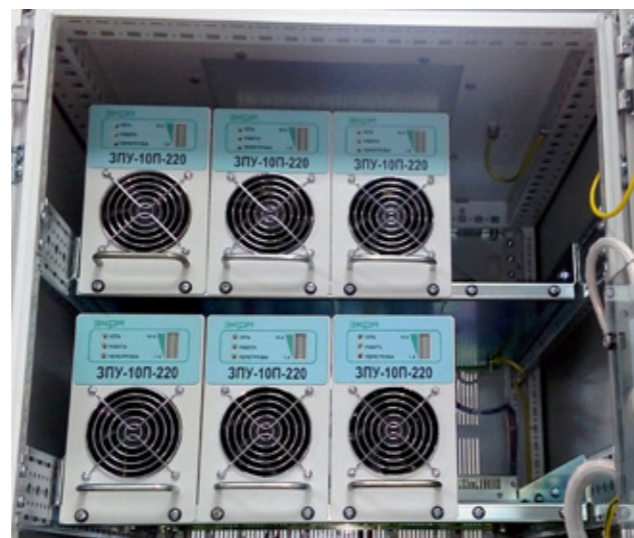
Модули ЗПУ-10П, установленные в кассете шкафа ШОТЭ
